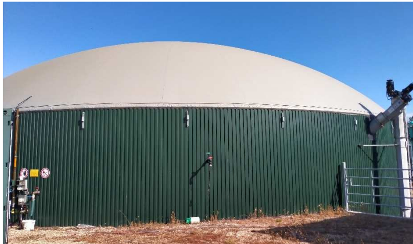
Figure 3 : Cuve du digesteur
