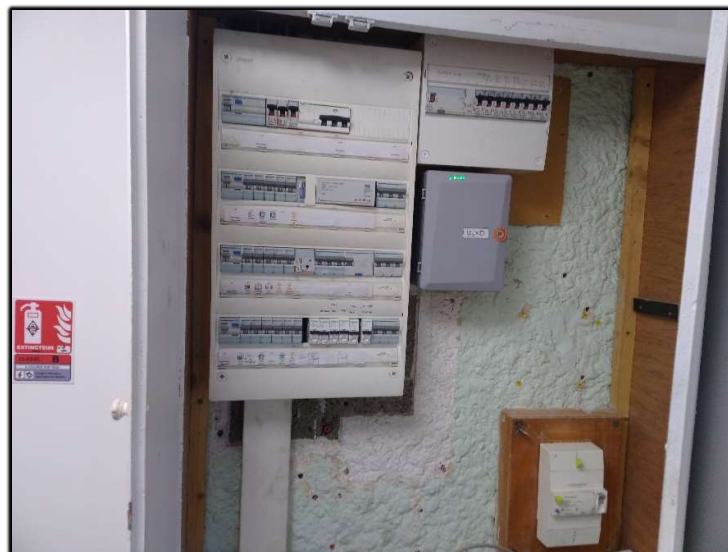
TGBT Bâtiment existant
