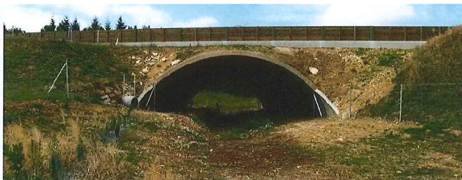
Photo 49 : Ouvrage inférieur de l'autoroute A88 équipé d'un écran d'occultation (Source : Groupe mammologique Normand)
